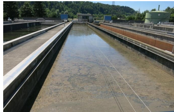
Abb. 11: Schlammteppich in Vorklärbecken, 05.07.19
